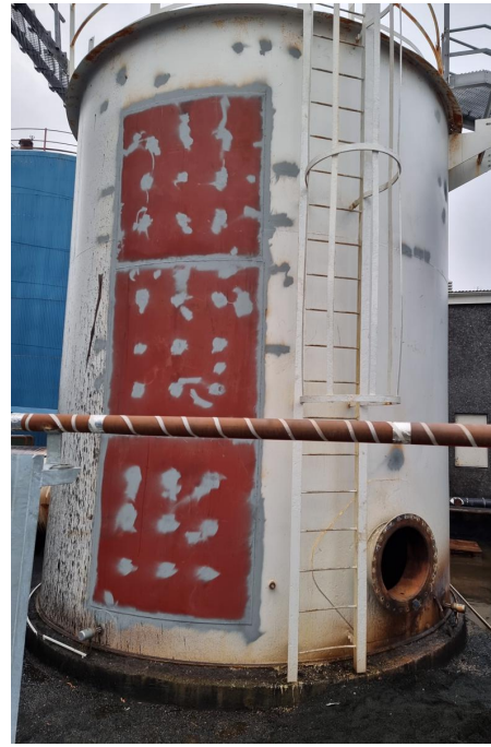
Mynd 6. Settar voru plötur yfir tæringarsvæði..
